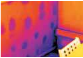
L'immagine ad infrarossi mostra la presenza di muffe sulla parete interna, dovute ad infiltrazioni d'acqua.
